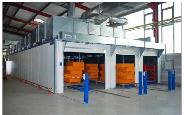
Halle de peinture avec tunnel de séchage
