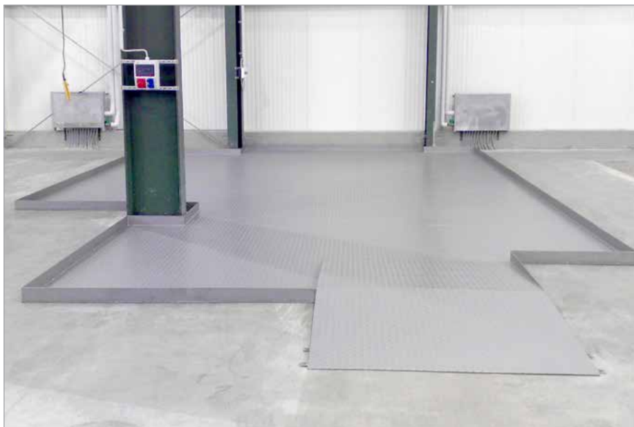
Revetement de protection du sol avec niche pour le pilier et rampe d'accès
