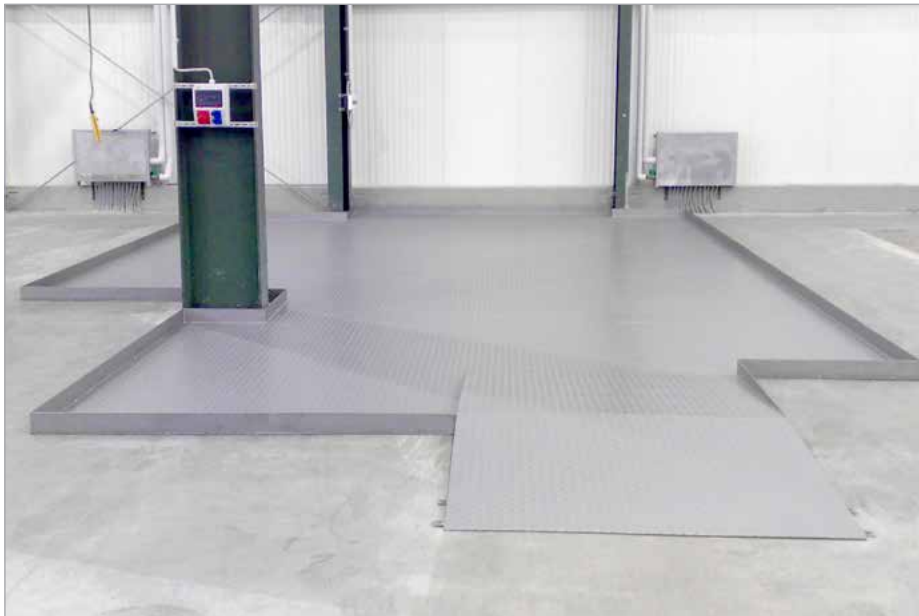
Bodenschutz-Auskleidung mit Aussparung für Pfeiler und Überfahrrampe
